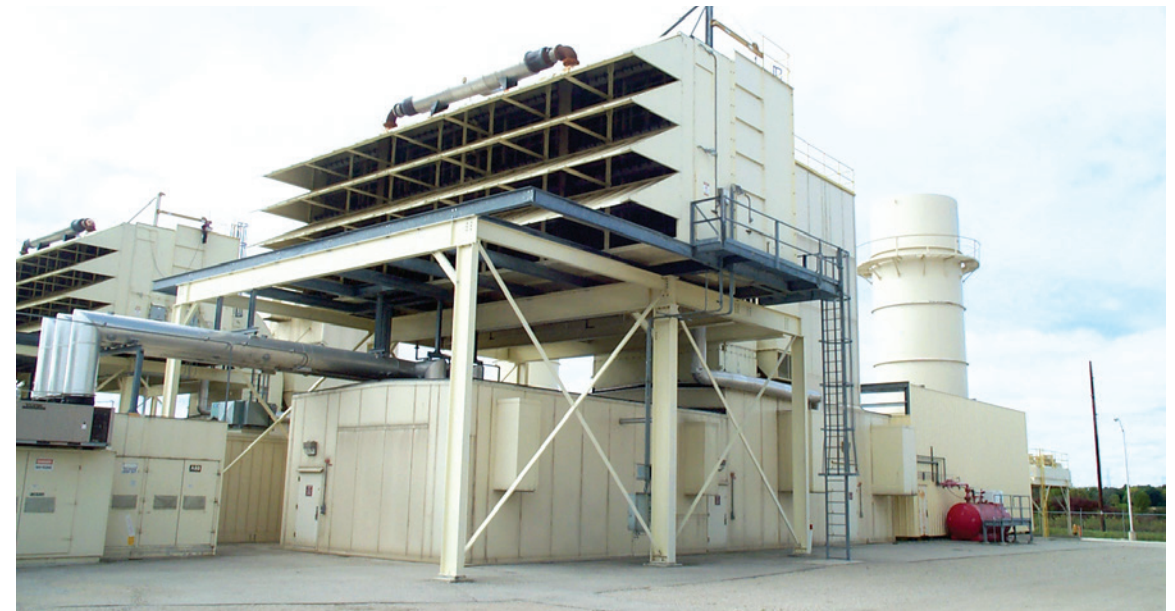
South Fond du Lac Combustion Turbine Unit 4.
